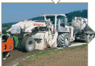
Mischen von alter Tragschicht und Deckschicht und Wasser zur Erstellung einer neuen hochwertigen Tragschicht.
